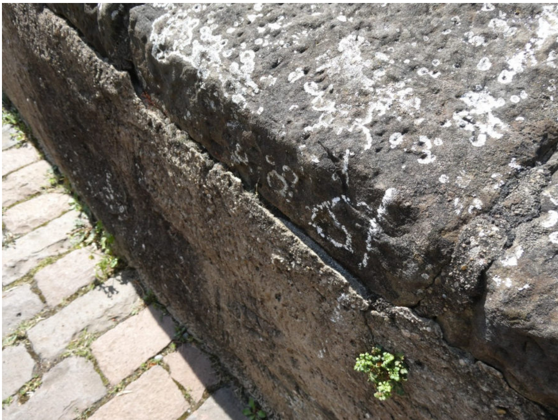
Bild 34 Detailaufnahme Anschluss Abdecksteine an Brüstungsmauerwerk: überstehender Putz und Risse führen zum Eindringen von Wasser und zu Schäden im Mauerwerk
