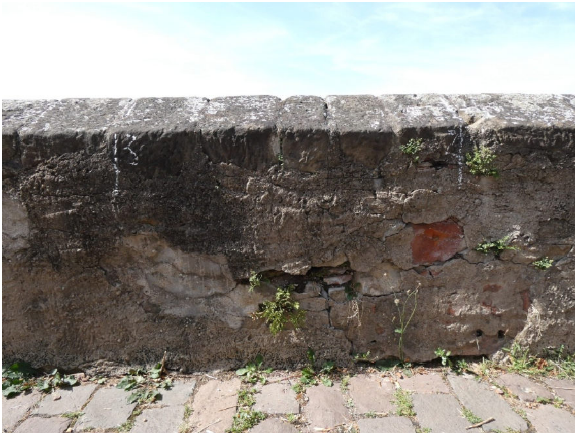
Bild 27 wie Bild 25; teilweise Fremdmaterial im Mauerwerk vorhanden (z.B. Dachziegel); Bewuchs in den Fugen
