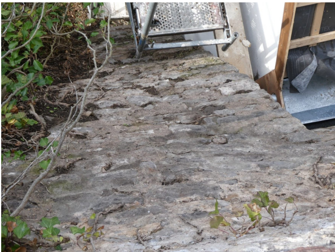
Bild 20 wie Bild 15; hier: Ansicht von oben; schadhafte Verfüllung mit Zementmörtel
