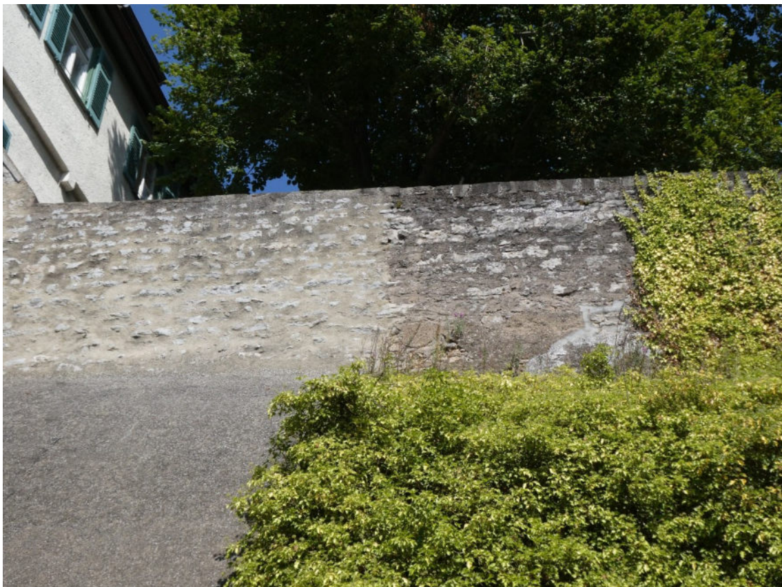
Bild 8 Detailaufnahme zu Bild 6: schadhafte Verfugung und flächiger Mörtelauftrag; in Teilbereichen dichter Efeubewuchs; Übergang zum bereits sanierten Mauerabschnitt (2012)
