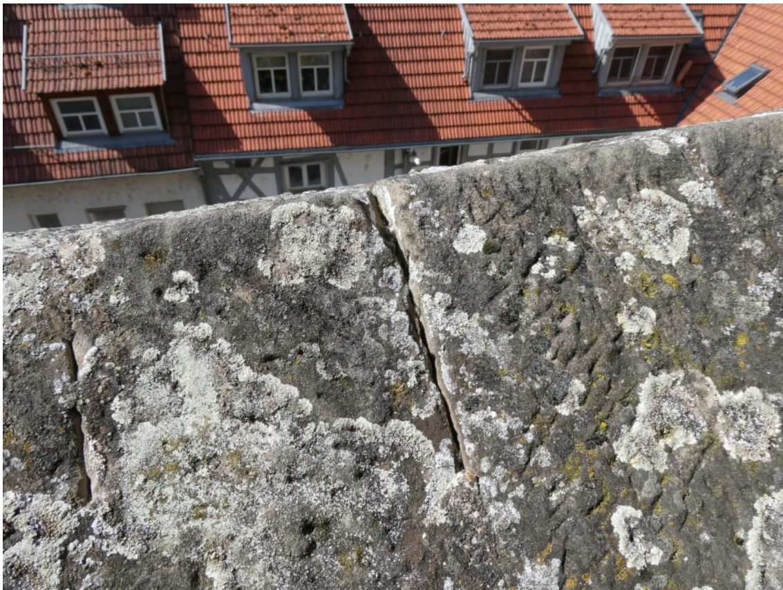
Bild 29 Abdecksteine des Brüstungsmauerwerks: biogener Bewuchs und schadhafter bzw. fehlender Fugenmörtel in den Stoßfugen
