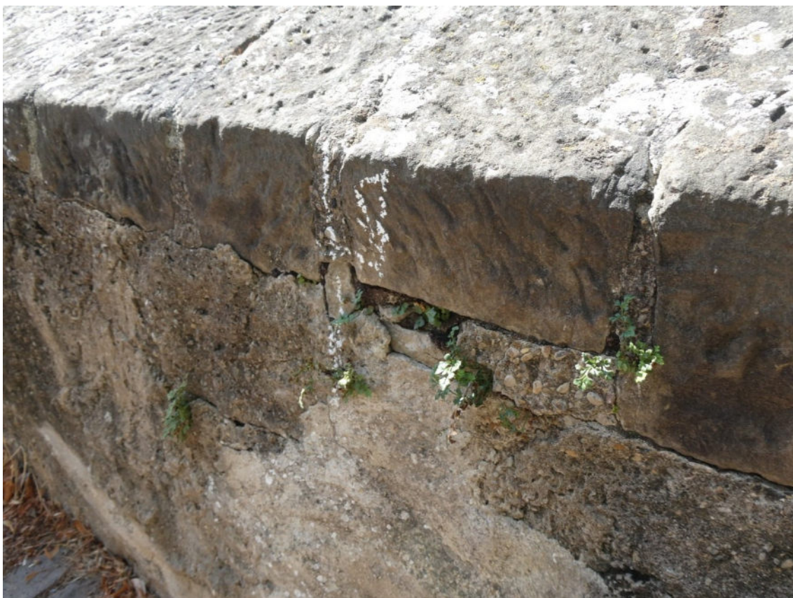
Bild 32 Abdecksteine: schadhafte Lagerfuge
