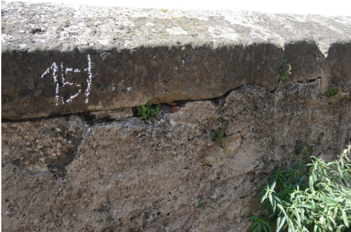
Bild 33 Abdecksteine: schadhafte Lagerfuge und mangelhafter Anschluss an Brüstungsmauerwerk
