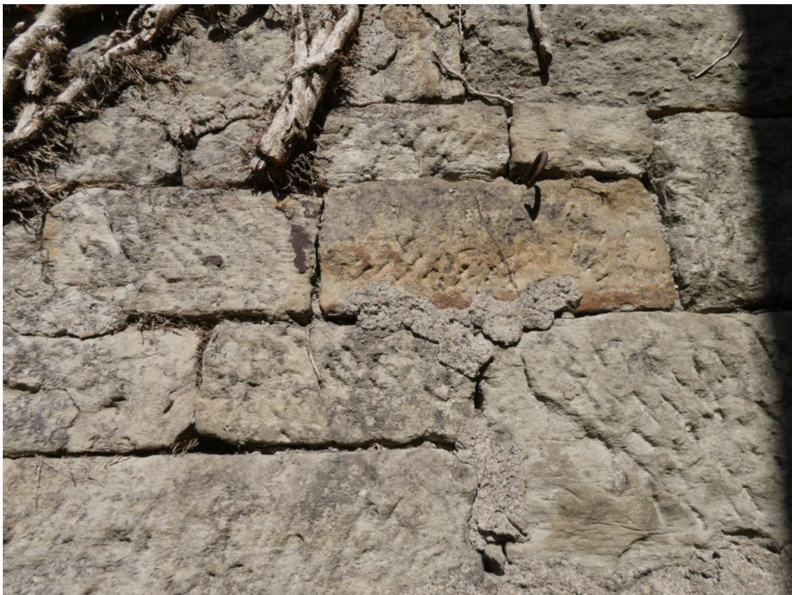
Bild 4 Detailaufnahme zu Bild 3: schadhafte Verfugung; Neuverfugung als Handverfugung erforderlich
