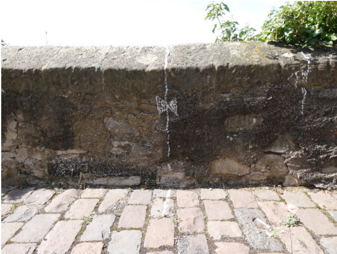
Bild 25 Ansicht Teilabschnitt des Brüstungsmauerwerks: Mauerwerk flächig mit hartem Zementmörtel überzogen; zahlreiche Schad- und Fehlstellen; gestörtes Mauergefüge
