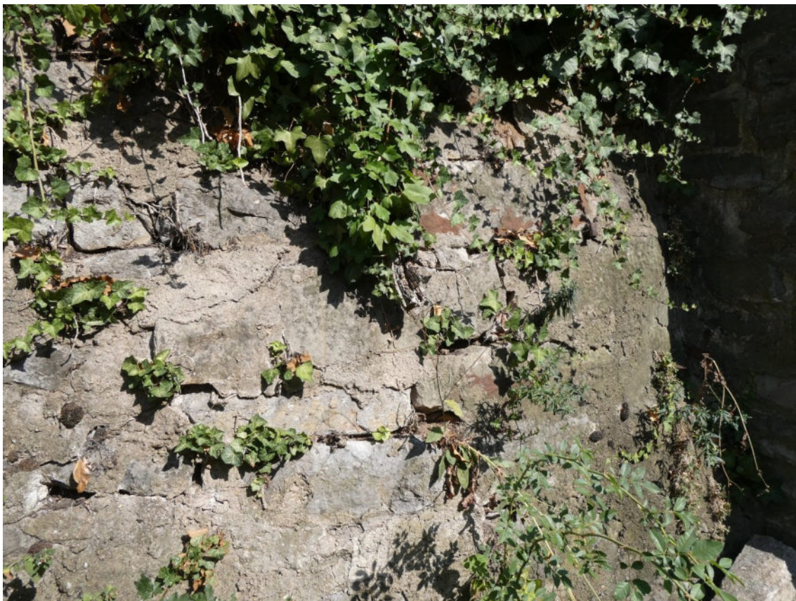
Bild 18 Detailaufnahme zu Bild 17: ausbauchendes Mauerwerk mit schadhafter Zementverfugung; klaffende Fugen mit Bewuchs
