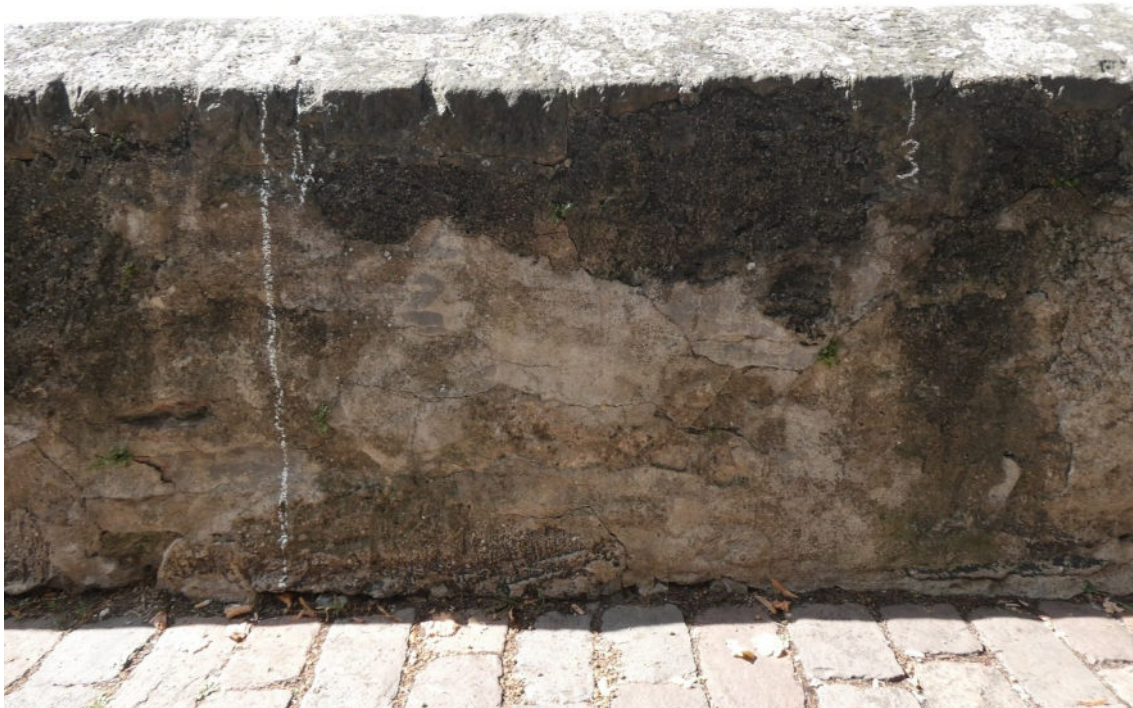
Bild 28 wie Bild 25; starke Rissbildung in den Putzflächen; das Schadensbild zeichnet sich über die gesamte Länge des Brüstungsmauerwerks ab
