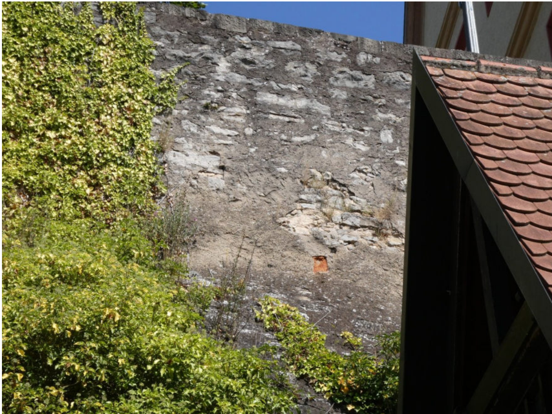
Bild 7 Detailaufnahme zu Bild 6: schadhafte Verfugung und flächiger Mörtelauftrag; in Teilbereichen dichter Efeubewuchs
