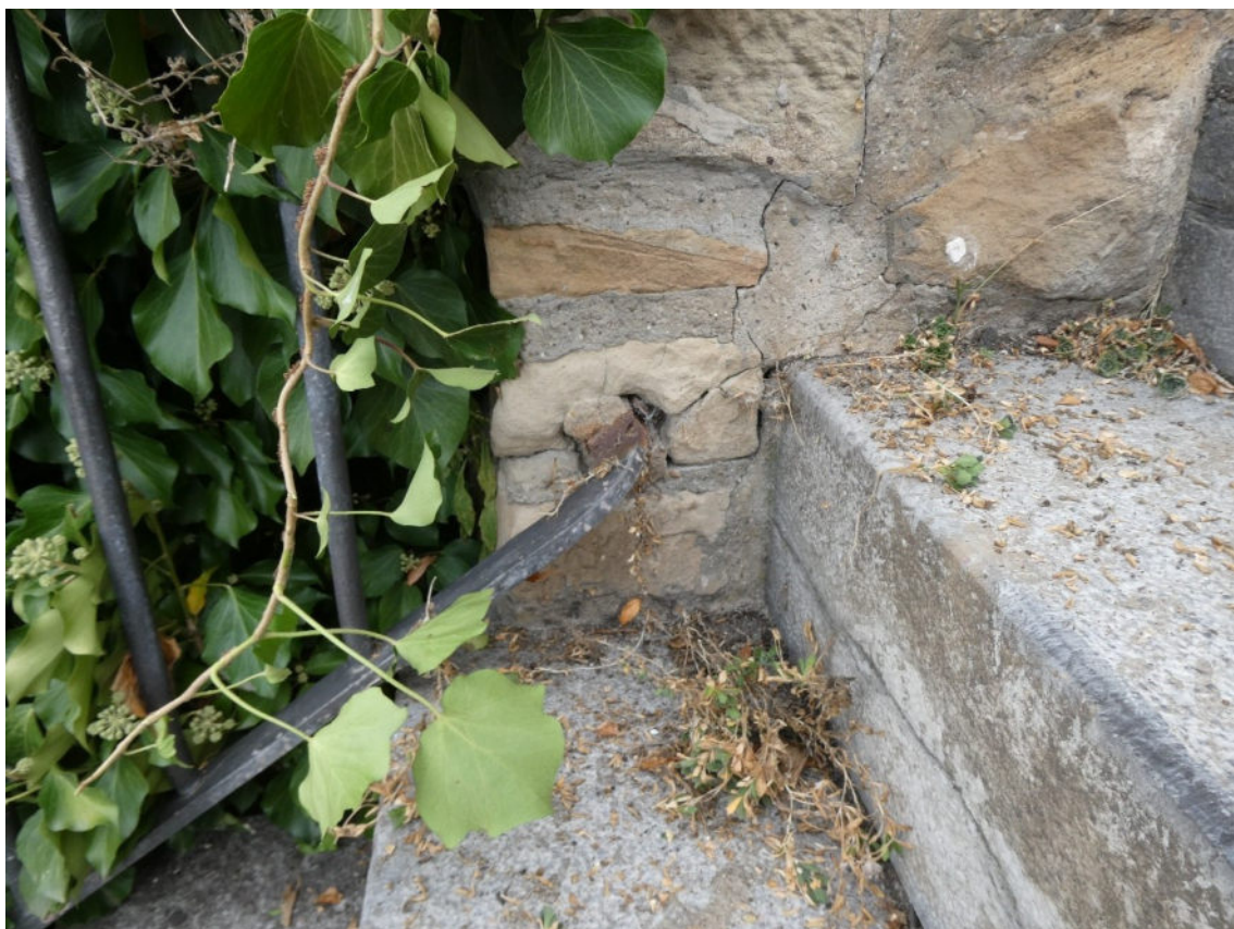
Bild 24 Detailaufnahme zu Bild 23: Mauerwerksschäden durch Korrosion des Stahlgeländers
